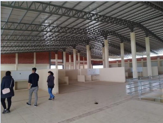
Fiscalización Proyecto: Construcción Mercado Municipal Abasto Bermejo. en conjunto con Técnico UPRE.
