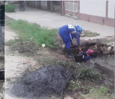
Limpieza de boca tormenta c/Aniceto arce alado de la plazuela B° Bolívar
