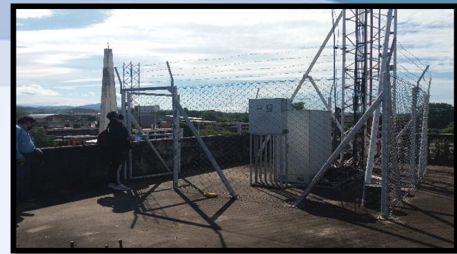
4 INSPECCIÓN DE ANTENAS RADIO BASES ENTEL, DIRECCION DE MEDIO AMBIENTE Y RR.NN;
